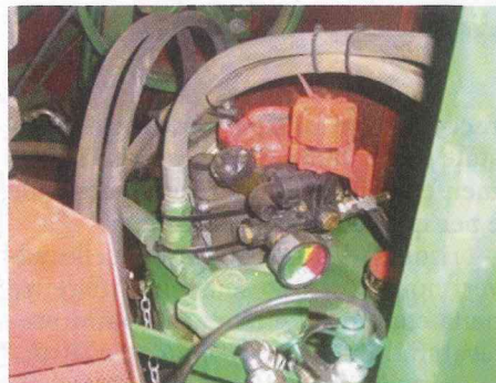
Foto 5 Pompa a membrana-pistone collegata all'impianto idraulico della macchina. Fonte Annovi e Reverberi.
